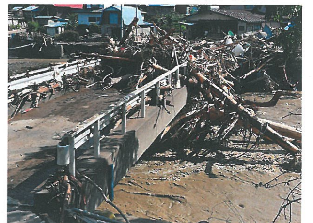
写真6：平成28年台風10号岩手県岩泉町
